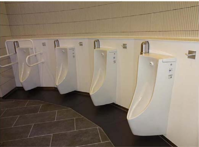
床の清掃性や節水性に優れた低リップ壁掛小便器を、アーチ形に配列し、設置している。
