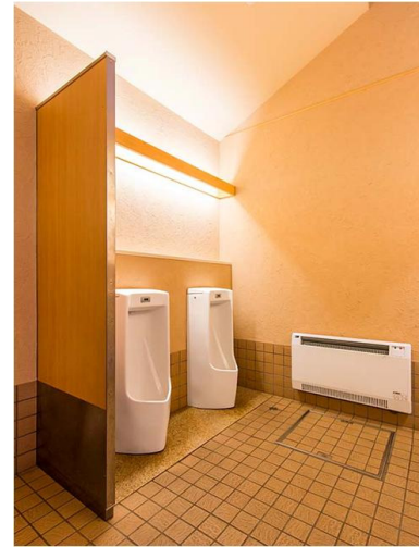
冬場でも快適に使用できるように、小便器コーナーにもパネルヒーターを設置している。
