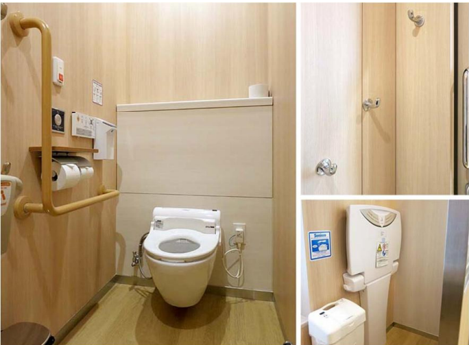
女性トイレ 大便器ブース・おむつ替えコーナー
