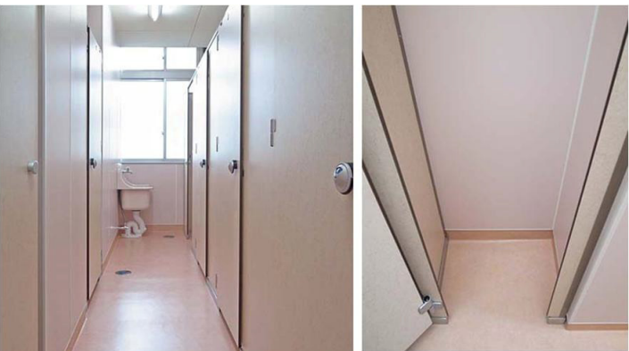
女子トイレ 大便器コーナー・掃除道具入れ
