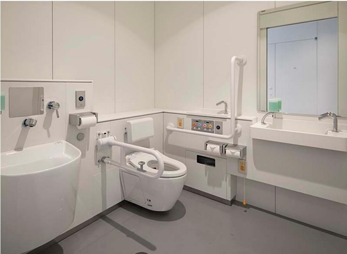
3フロアのトイレすべてに多機能トイレを備える。オストメイト対応トイレバック、車いすから移乗しやすい跳ね上げタイプの手すり・L型手すり、座位の安定をサポートする背もたれなどを設置。
