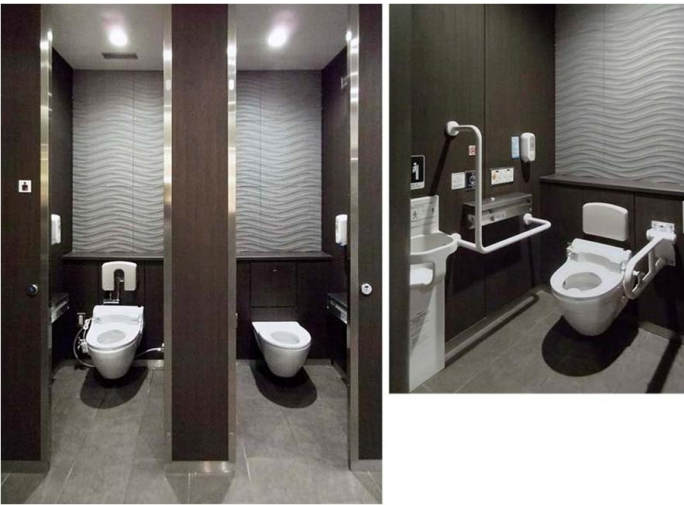
男性トイレ 大便器ブース
