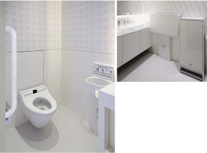
乳幼児配慮として、ベビーチェアを女性トイレにすべて、男性トイレには半数設置。そのほか、男女トイレに1ヶ所ベビーシートを設置している。
