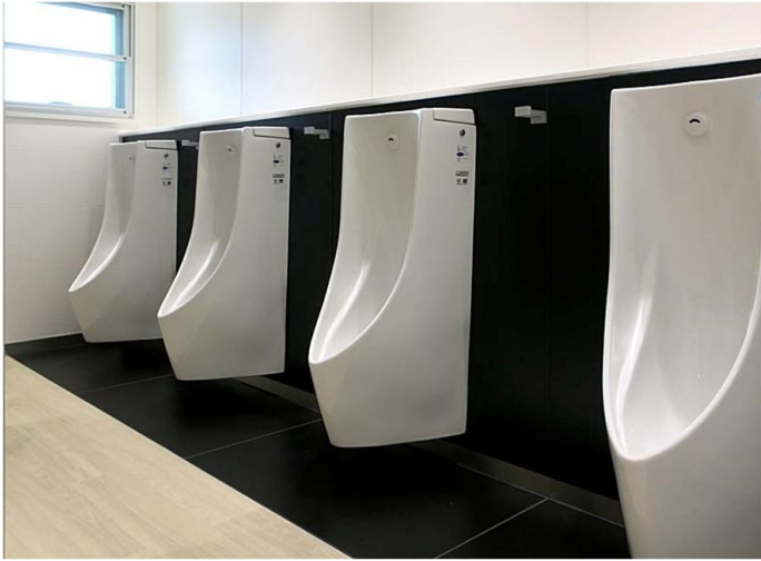
小便器前板と小便器下には光触媒機能による防汚・防臭効果のあるハイドロセラ・ウォールとハイドロセラ・フロアを採用。メンテナンス性の良い内装材で仕上げることで、快適な空間を実現。
