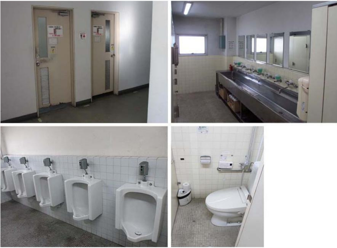
改修前トイレは、タイル貼りの内装、設備の老朽化が見られ、時代にそぐわないトイレ環境だった。
