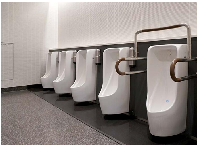
小便器は床の清掃性や節水性に優れた壁掛式の自動洗浄小便器を採用。1ヶ所には手すりを設置している。
