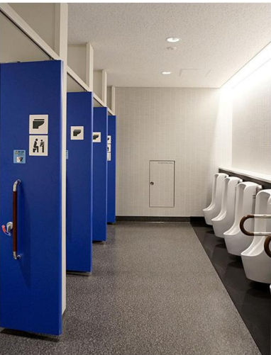
大便器ブースの扉にはトイレの設備がひと目でわかるサインを表示。
