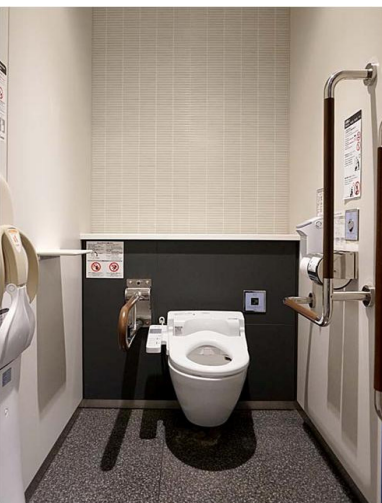
高齢者、障がい者の使いやすさに配慮して、すべての大便器ブースにL型手すりとはねあげ手すりを設置している。ブースサイズは大きな荷物を持ち込みやすいように、幅1200mm×奥行き2000mmを確保している。
