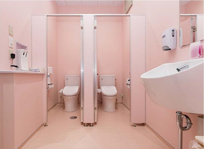
洋式節水便器とウォシュレットの採用により、節水性と使いやすさが大幅に向上。人感センサーを搭載した明るい照明と内装色により、空間の広さを感じさせる室内となった。
