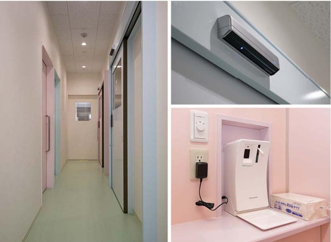
トイレ入口は、男女別の内装テーマカラーで色分けされている。ドア上部のセンサーにより入室し、退室時はセンサー式のアルコール消毒液供給器を使用しないとドアが開かない仕組みとしている。
