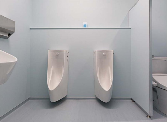
男性トイレでは、節水型の自動洗浄小便器を採用。（改修前：4L/回⇒改修後：1.2L/回）壁掛けタイプにより、器具のまわりがスッキリし、床の清掃性が向上した。
