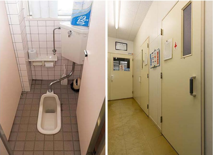
自動水栓や消毒液供給器の設置はあったがドアは自動化されていなかった。器具も和式のみで、特に女性用トイレは器具数が少なく、休憩時間に混雑することがあった。
