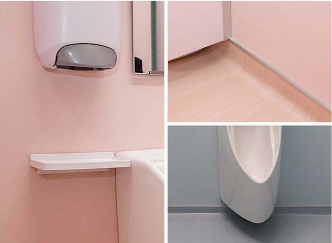
（左）床の汚れ防止として、水石けん供給器の下に受け皿を設置。（右上）清掃性に優れたドライ床とし、巾木部をR型に立ち上げている。（右下）壁掛小便器の採用により、清掃性を向上させている。
