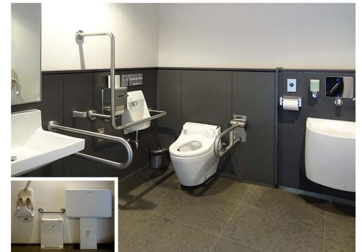
オストメイトや小さなお子様連れに配慮して、オストメイト対応トイレパックとベビチェア・ベビーシート・フィッティングボードを設置している。
