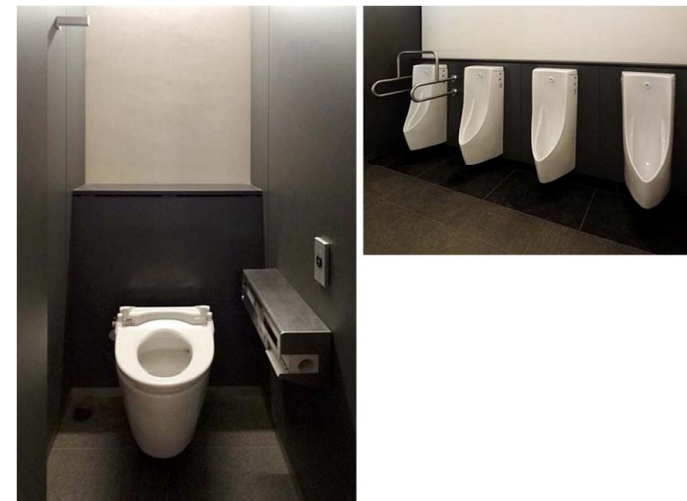
大便器は、清掃性に配慮し壁掛大便器セット・フラッシュタンク式を採用。小便器は、デザイン性が高く、ライニング高さを低く設置できる自動洗浄小便器を採用。
