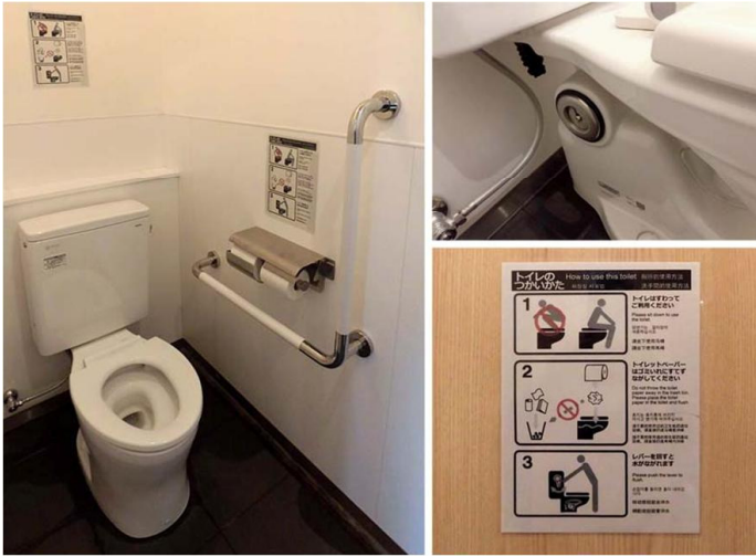
東棟 女性トイレ
