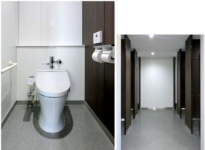
共通講義棟東 7F女性トイレ 大便器ブース
