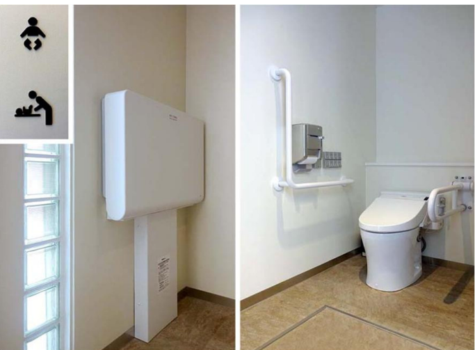
女性トイレ ひろびろブース
