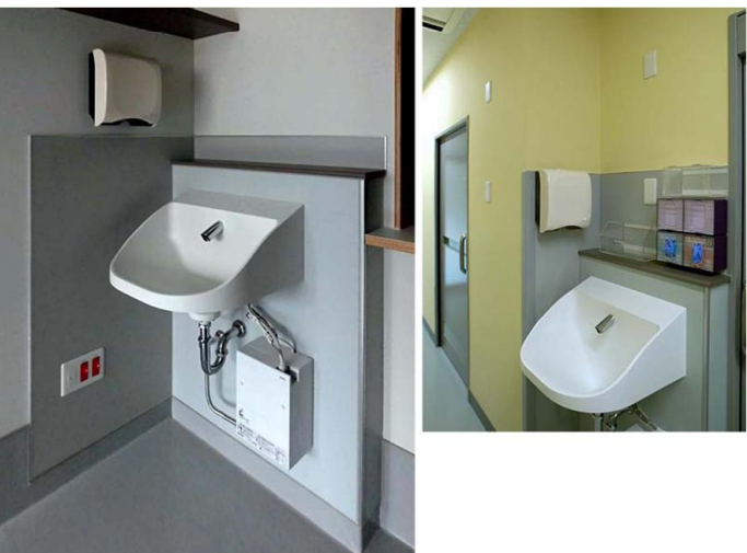
感染症対策として、スタッフルームと検査室にはボール面が大きく、入念なスタッフの手洗い行為に配慮した病院用洗面器(特殊対応品)を設置。清掃性に配慮し、周囲の壁材は汚れにくい素材を採用した。
