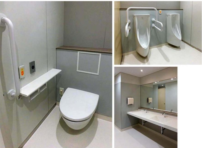
外来・病棟共に大便器は、清掃性に配慮し壁掛大便器を採用。床材を巾木の高さまで立ち上げ、壁と床の継ぎ目をなくしている。洗面器の水栓は非接触で衛生的な自動水栓を設置した。
