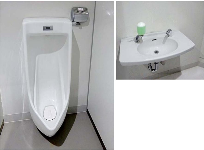
床の清掃性に優れた低リップタイプで壁掛式の自動洗浄小便器を採用。洗面器はカウンター一体形洗面器に自動水栓と石けんをセット。
