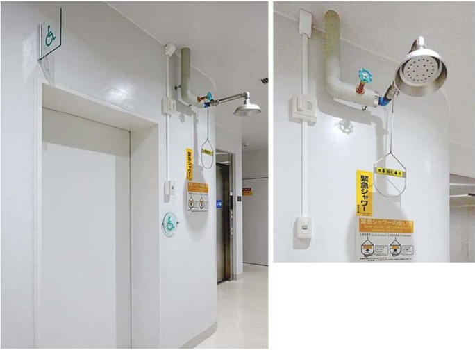
実習や実験において、万が一、危険な薬品を浴びてしまった際に、ただちに洗い流せるよう、トイレ前の廊下に緊急シャワーを設置している。
