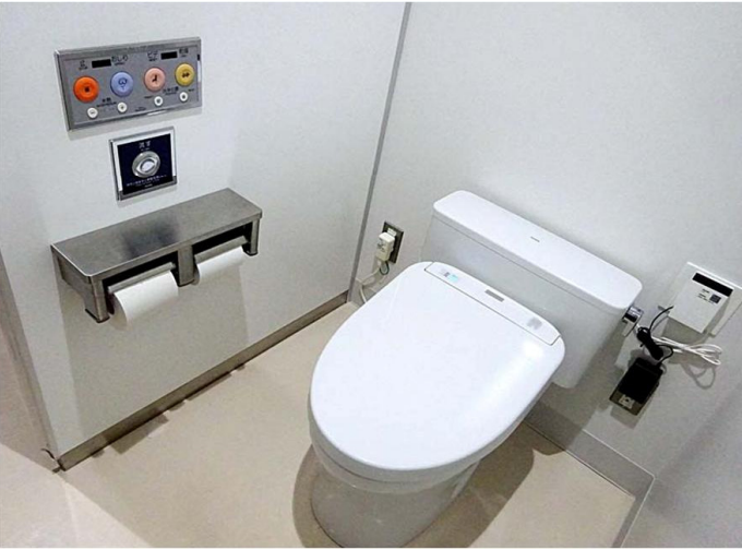
コンパクト設計で連続使用が可能なフラッシュタンク式大便器を採用。便座は「きれい除菌水」機能により、毎回使用後に、便器表面やノズルの清潔を保つウォシュレット「アプリコット」をセットしている。
