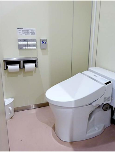
メンテナンス性に配慮。異物が詰まったとき簡単に取り除くことができる掃除口付きのフラッシュタンク式大便器を採用。便座は、電池交換の不要な発電式のエコリモコンタイプのウォシュレットPSを設置。
