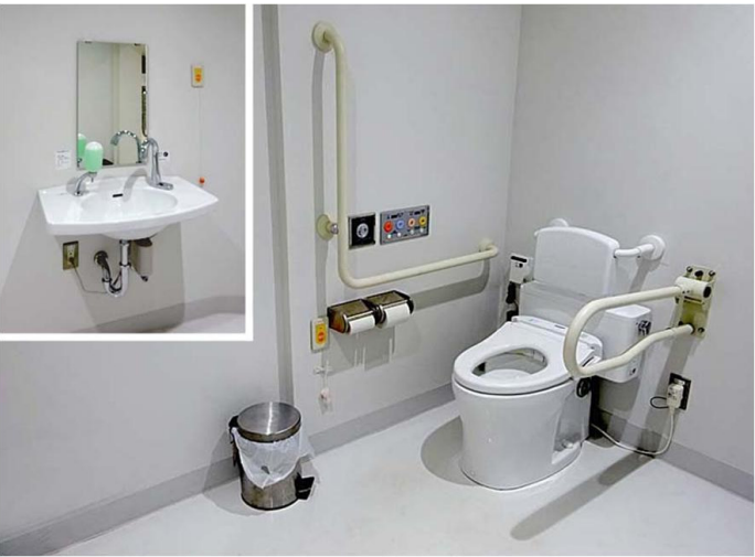
車いす使用者が円滑に使用できる広さを確保した多機能トイレ。L型手すり・はね上げタイプの手すりのほか、座位の安定をサポートする背もたれも設置。
