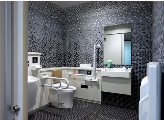
建物内に2ヶ所設けた多機能トイレは、必要な設備がパッケージされたコンパクト多機能トイレパックを採用。さまざまな身体状況の使用者に配慮し、汚物流し、収納式多目的シートを完備。
