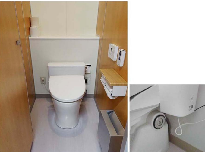
7号館1F女性トイレ 大便器ブース
