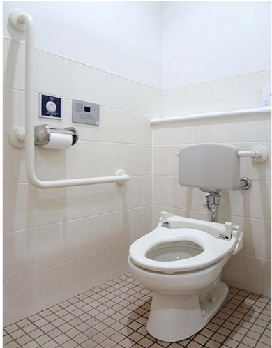
低学年用トイレ 大便器ブース
