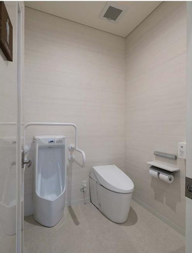
ゆったりとしたスペースを確保し、大便器と小便器を併設している。環境に配慮して、大便器は3.8L洗浄のウォシュレット一体形便器、ネオレストハイブリッドシリーズAHタイプを採用。
