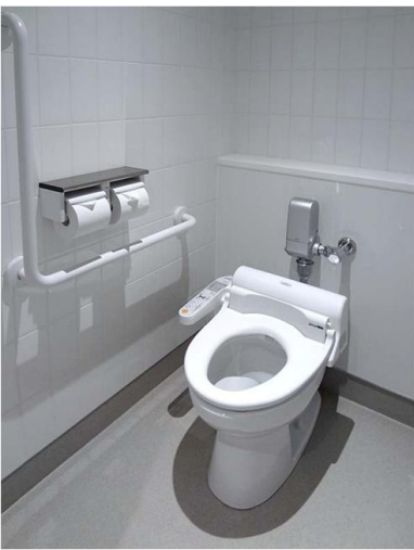
女性トイレ 大便器ブース
