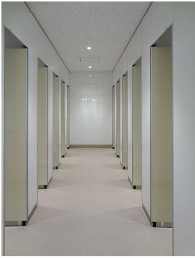
女性トイレ 大便器コーナー
