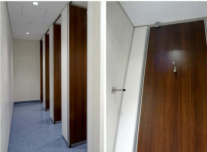
女性トイレ 大便器コーナー
