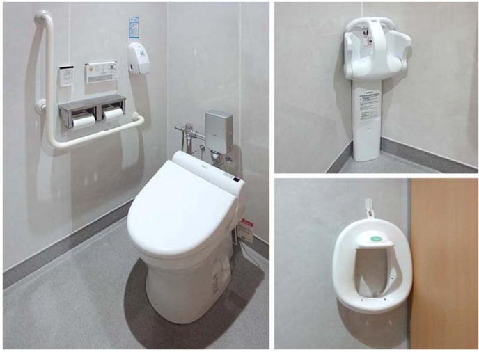
男性トイレ 大便器ブース
