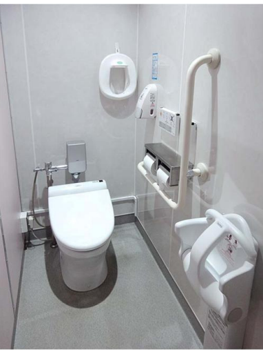
女性トイレ 大便器ブース
