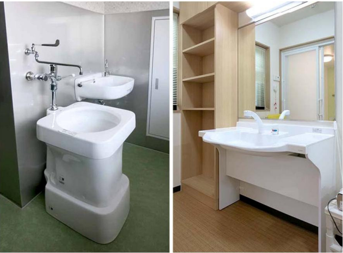
洗濯室にはスタッフが楽な姿勢で作業できるように、補高台付きの汚物流しを設置。壁は清掃性に優れた素材を使用している(写真左)。脱衣室には、車いす対応洗面カウンターを採用している(写真右)。
