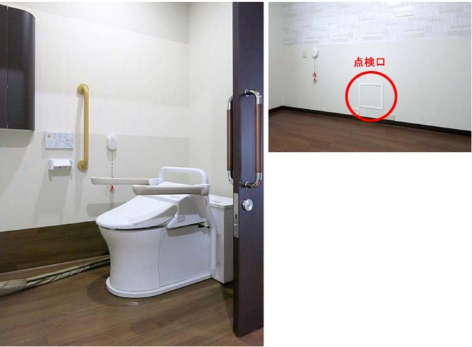
45部屋ある居室の内2部屋にベッドサイド水洗トイレを設置。通常はトイレ内に設置されている便器を、入居者の身体状況の変化に応じてベッド横に移動できるように、室内に接続用の点検口を設けている。
