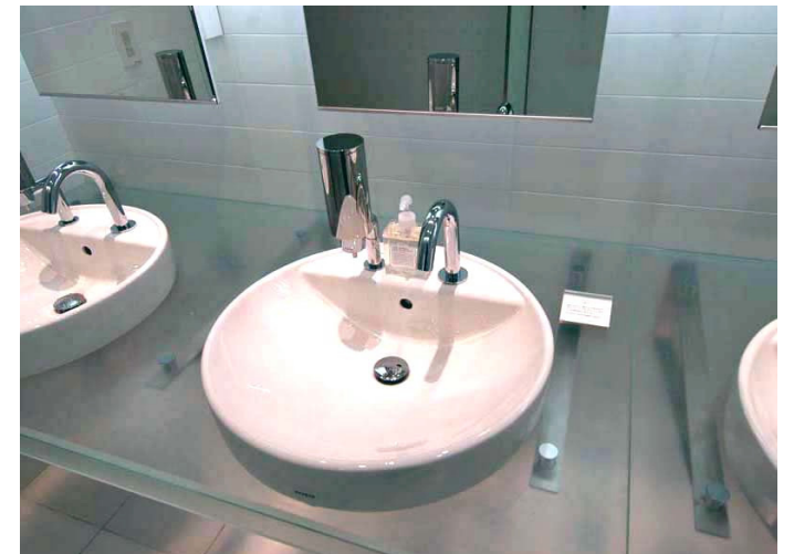
【商業】3F 女性トイレ 洗面器
