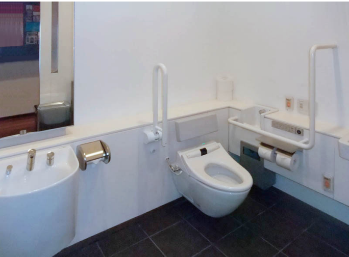
RESTROOM ITEM 01を採用した多機能トイレには、オストメイト対応マルチバックの大型鏡・汚物流しなどの器具が設置されている。
