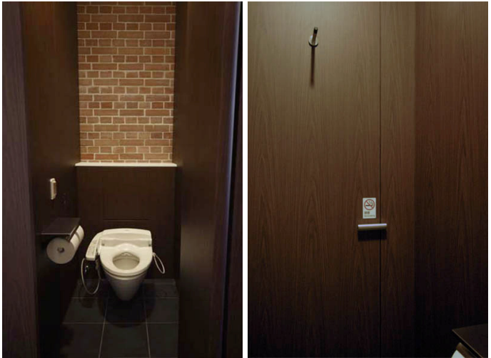
男女トイレとも、すべてのブースに清掃性に優れた壁掛式の大便器、ウォシュレットを採用。扉には、荷物に配慮してフックを設けた。
