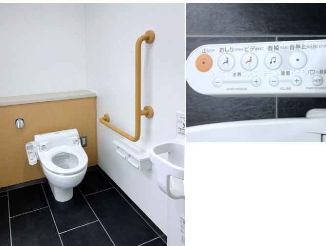
お子様連れに配慮したひろびろブース。音姫（擬音装置）機能を搭載したウォシュレットを設置している。
