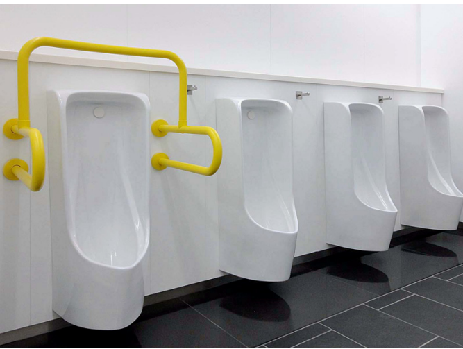
1ヶ所には手すりを設置。小便器の間には、傘や荷物が掛けられるフックを設けている。
