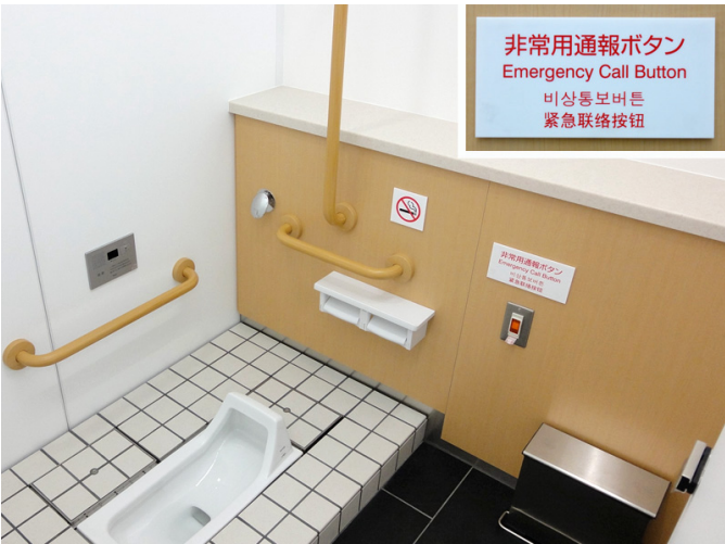
だれもが利用しやすいよう、すべての大便器ブースに手すりを設置。また安全対策として、女性トイレには非常ボタンを取り付けている。
