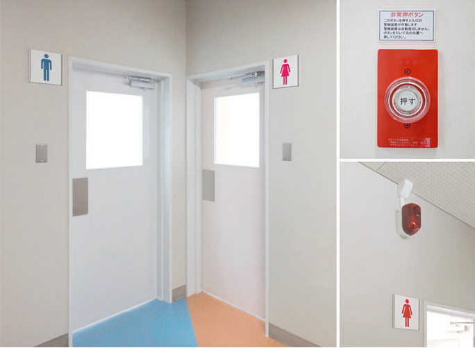
トイレ入口・防犯対策
