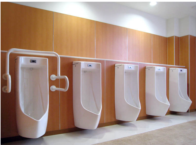
隣の使用者が気にならないよう、小便器の間にゆとりを持たせた。足元には、尿の飛散などに配慮した清掃性の高いハイドロセラ・フロアを採用。
