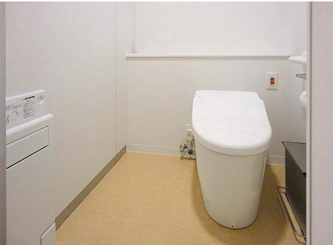
すべての大便器ブースには4.8Lのウォシュレット一体形の節水便器を標準仕様とし、女子トイレには音姫（擬音装置）も設置。着替えができるように手すりの設置された大便器ブースに、フィッティングボードを採用した。
