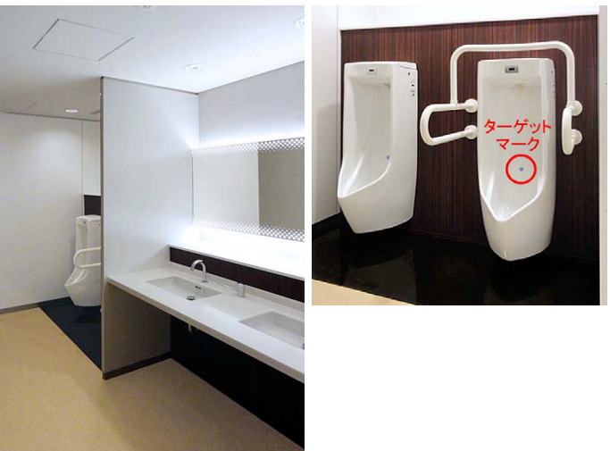
清掃性に配慮し、壁掛式低リップタイプの小便器を設置し、学校側のこだわりでもあるターゲットマークを貼り付けた。
