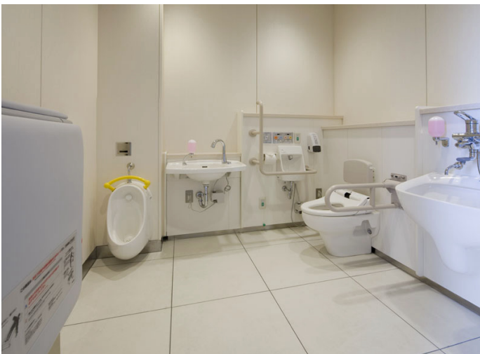
5階と10階に設置した多機能トイレ。車いす使用者、乳幼児連れ、オストメイトの方まで幅広く対応できる設備を整えている。
