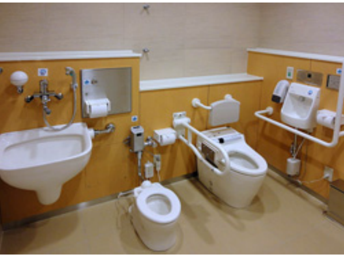
オストメイトに配慮した汚物流しと、幼児用大便器を備えた多機能トイレ。すべての多機能トイレに幼児用大便器を設置している。
