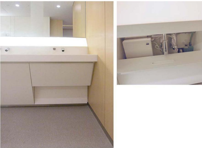
男性トイレ同様、洗面カウンター下のパネルを斜めに取り付け、車いす使用者がアプローチできるようにしている。カウンター下にはコンパクトな電気温水器を収めている。
