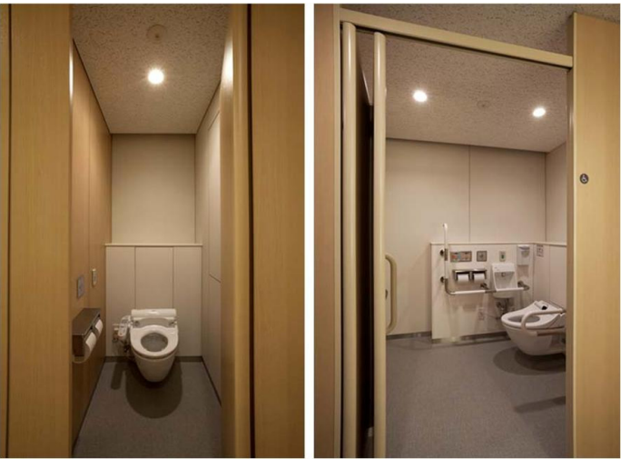
すべての大便器ブースに、床の清掃性に優れた壁掛大便器を採用。男性トイレ同様、車いす使用者に配慮したひろびろブースを1ヶ所設けている。
