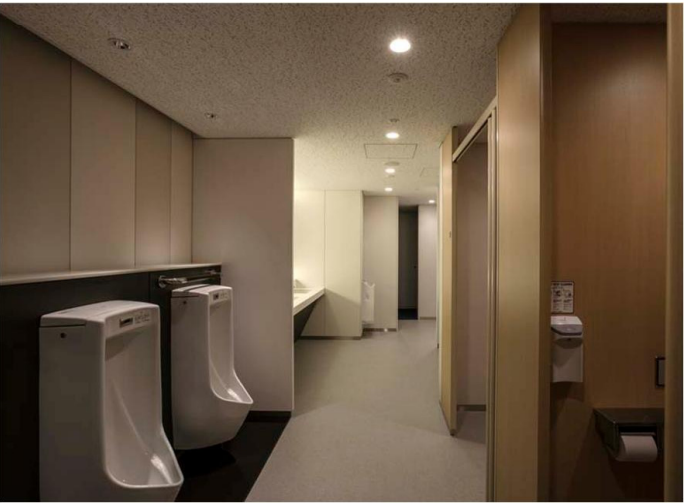
床の清掃性に優れた低リップタイプの壁掛小便器を採用している。
