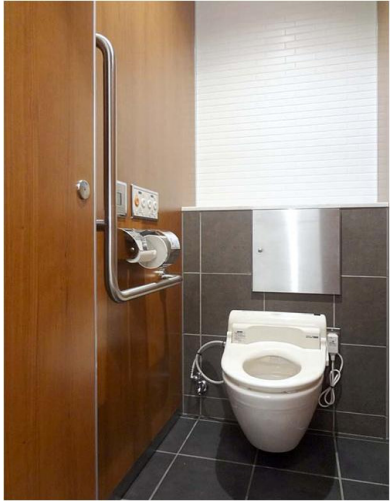
小便器同様すべての大便器ブースに手すりを設置。大便器は床の清掃性に優れた壁掛式を採用し、すべてにウォシュレットを設置している。
