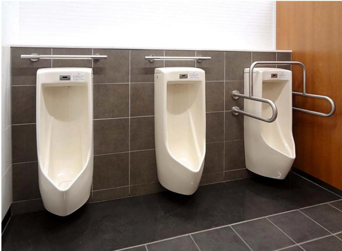
床の清掃性や節水性に優れた壁掛式の低リップタイプ自動洗浄小便器を採用。すべての小便器に手すりを設置している。
