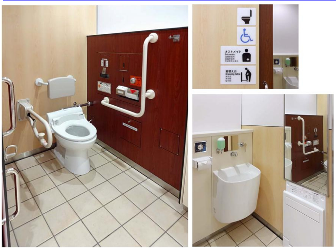
男女トイレともに、車いす使用者対応ブースを設置。オストメイト対応の汚物流しと、着替えができるフィッティングボード、姿見も完備している。
