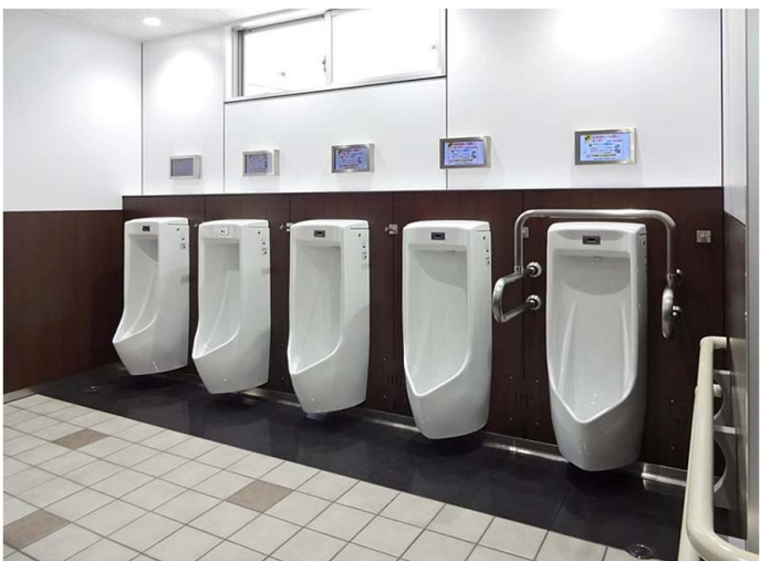
床の清掃性に優れた低リップタイプの壁掛小便器を採用。壁のモニターでは交通安全の啓発を行っている。
