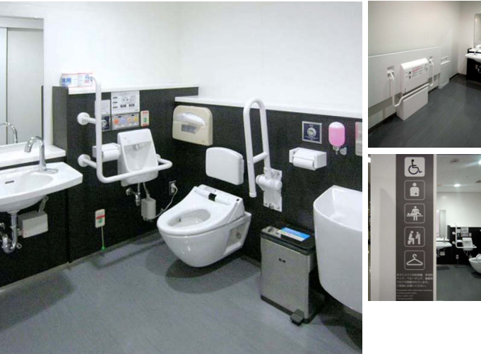
左右勝手違いの多機能トイレを2ヶ所設置。車いす使用者、オストメイト、乳幼児連れなど、さまざまな利用者を想定し、背もたれ・手すり・汚物流し・ベビーシート・ベビーチェア・大型ベッドなどを完備している。
