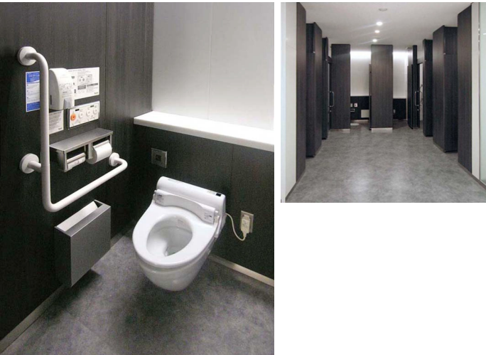
スーツケースが入るスペースを確保した大便器ブースは、間仕切り壁を天井まで立ち上げて個室感を高めている。節水性と清掃性に優れた壁掛大便器を採用し、すべてのブースに手すりを設置している。
