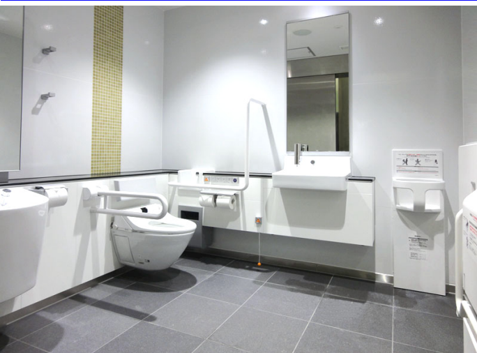
車いす使用者、オストメイトなど、さまざまな使用者を想定して、汚物流しやパブリック用折りたたみシート、ベビーチェアを完備したRESTROOM ITEM 01の多機能トイレユニットを採用。
