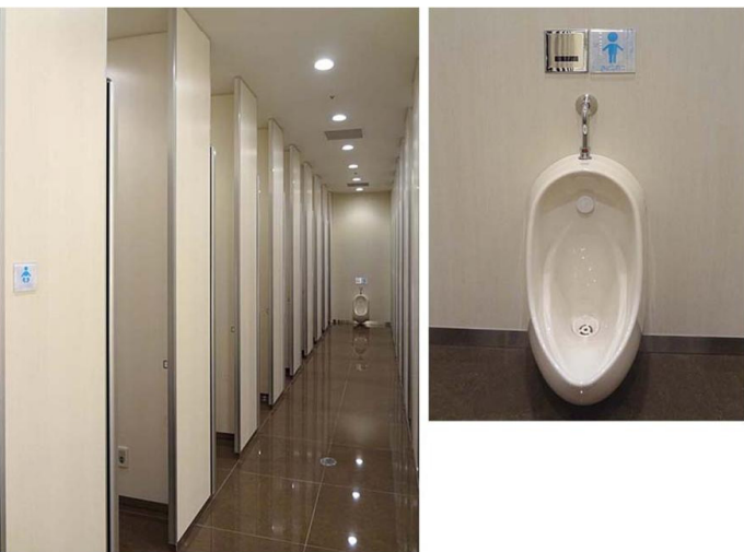
大便器ブースの間仕切りは天井まで立ち上げ、防犯対策を図るとともに 個室感も高めている。お子様連れに配慮し、大便器コーナーの奥には 幼児用小便器を設置している。
