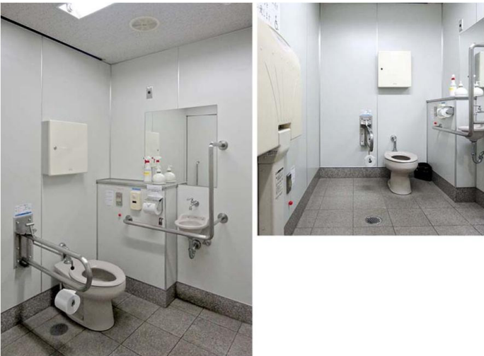
4Fと5Fの男女トイレには車いすトイレを設置。車いす使用者だけでなく、小さなお子様連れに配慮してベビーシートを備えている。
