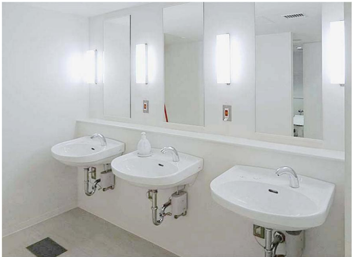
女性トイレ 洗面コーナー
