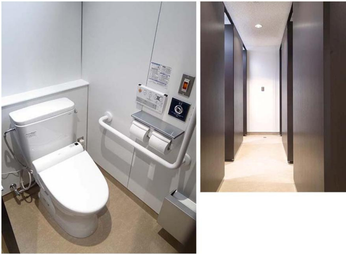
ダークブラウンが基調のシックで落ち着いた空間。すべて洋式便器とし、ウォシュレットを設置した。女性トイレの大便器ブースには緊急呼出ボタンを完備し、非常時や具合が悪くなったときなどに配慮している。
