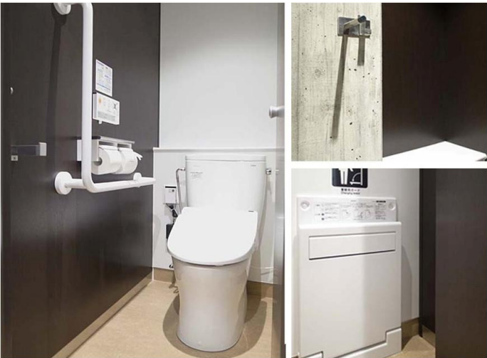
荷物配慮として、男女ともすべての大便器ブースにフックを取り付けている。また、大便器ブースの1ヶ所には着替え用としてフィッティングボードを設置している。
