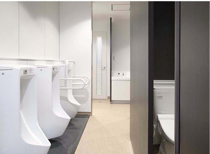
尿石の付着を抑制するジアテクト機能付きの壁掛式低リップタイプ小便器を採用。小便器の足元には、清掃性や防臭に配慮して尿の飛散による汚れやにおいを抑えるハイドロセラ・フロアPUを設置。
