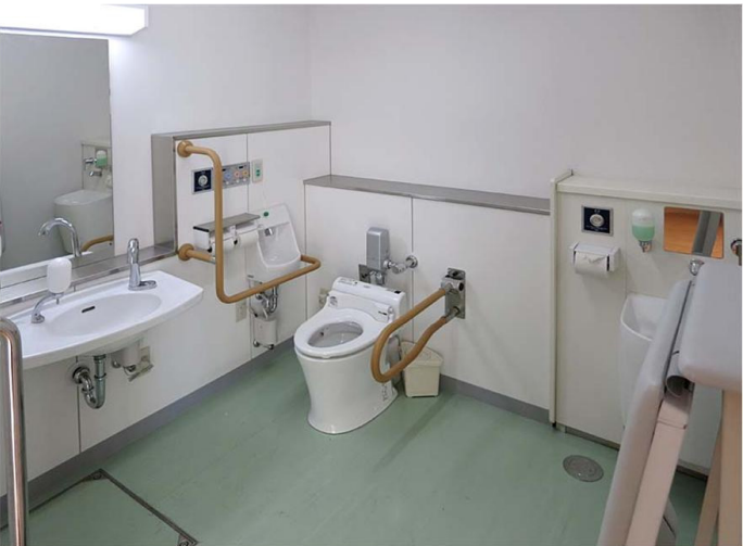
体育館 多機能トイレ
