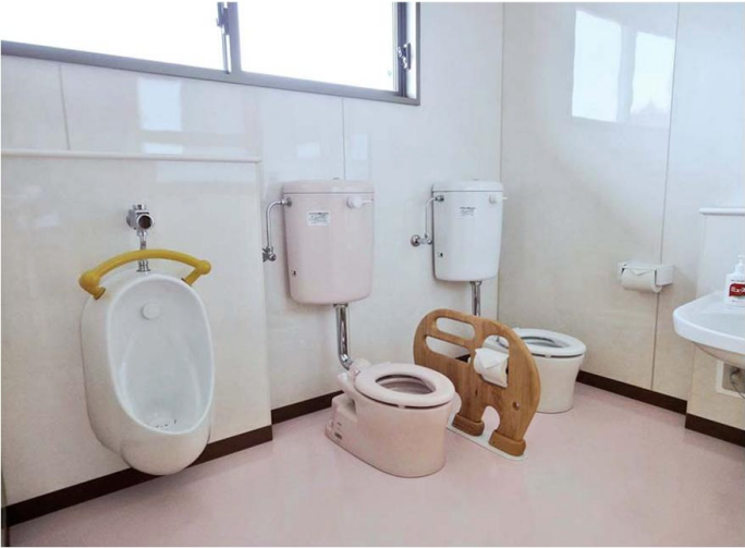
窓から自然光が射し込む明るいトイレ空間。身体のパランスがとりやすいように黄色のグリップ付きの幼児用小便器を採用。大便器コーナーは腰掛便器用手すり(ぞう)でさりげなく間仕切りしている。
