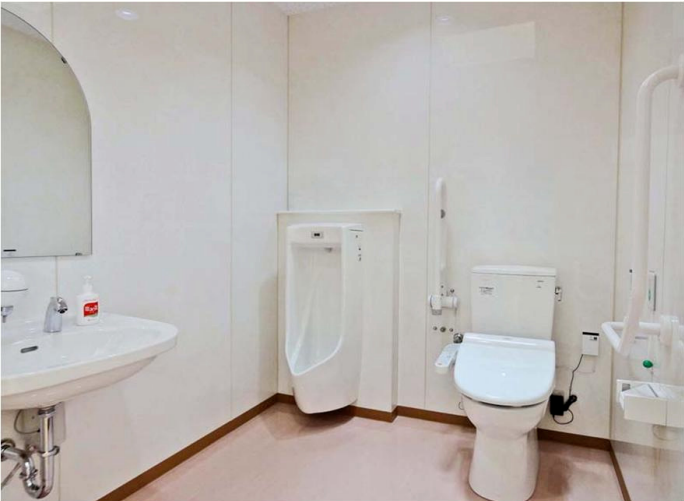
イベント時には地域の方々が訪れるため、多機能トイレを設置している。
