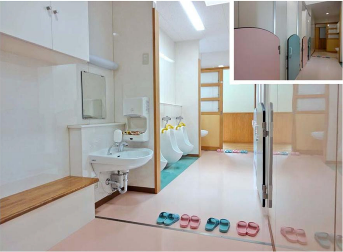
男子用はブルー、女子用はピンクに色分けしている。入口横には、洋服の着脱やトイレの順番待ちなどに使用できるベンチを設置。大便器ブースの扉は、中の様子が確認できるように低くしている。
