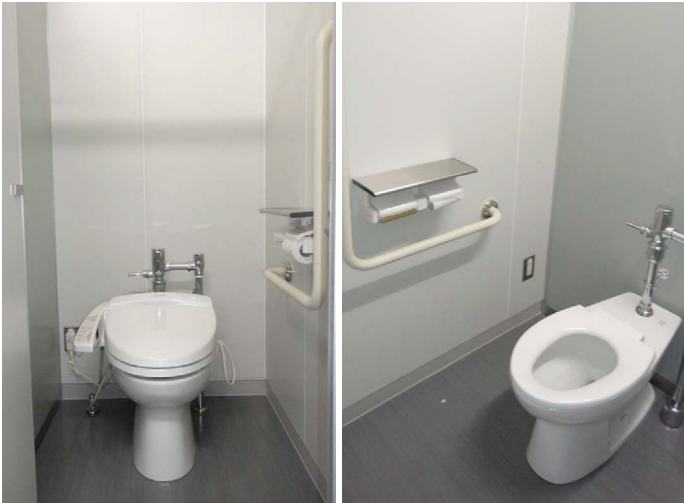
家庭環境に合わせてほとんどの大便器ブースに洋式便器を採用。また、すべての大便器ブースには手すりを設置。さまざまな方が利用されている体育館横のトイレには、ウォシュレットを設置している（写真左）。
