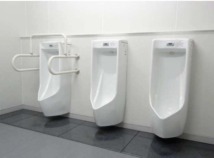
足下の床の清掃性に優れた壁掛式の低リップタイプの小便器を採用。
