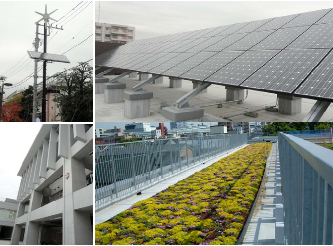
風力・太陽光発電設備を設け、発電した電力を教室の蛍光灯などに使用。また、雨水は植栽やトイレの洗浄水として再利用している。そのほか校舎東側には縦型ルーバーを設置し、夏の朝日を遮っている。
