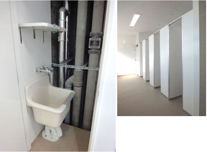
写真左：パイプシャフトスペース横の空間を有効活用し、掃除用流しと棚を設置。写真右：一番奥の扉が掃除用流しブース。
