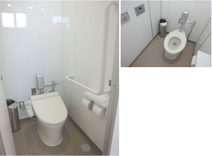
5.5L洗浄の節水タイプの洋式便器を採用。男女トイレとも1ヶ所にウォシュレットと手すりを設置。女子トイレには、アンケートで要望が多かった音姫（擬音装置）とチャームボックスを設置している。
