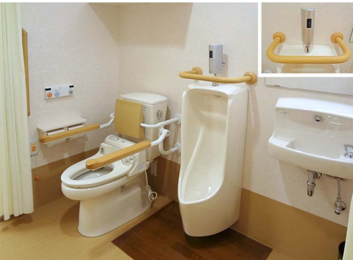
大便器には座位姿勢をサポートする背もたれ付きのアームレストを採用。小便器には立位の姿勢をサポートする手すりを取り付けている。
