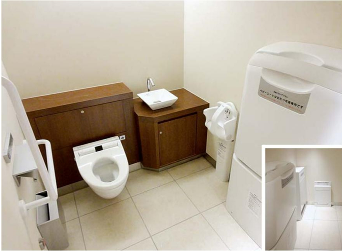
6F 女性トイレ ひろびろブース
