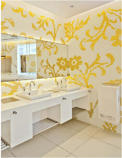
ベッセル式の洗面器にノンタッチで水の出し止めができるアクアオート（自動水栓）を設置。荷物配慮としてカウンターの足元には棚を設け、カウンター前面にフックも取り付けしている。
