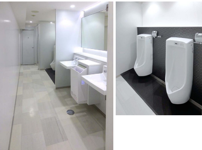
クリーンドライの上部に棚を設け、荷物置きとして利用できるようにしている。小便器の足元には、尿の飛散によるにおいや汚れを抑えるために、ハイドロセラフロアを設置。
