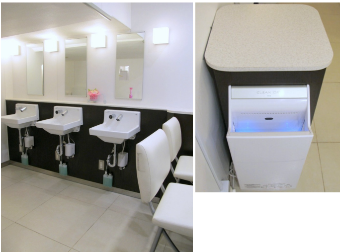
スペースを有効活用できるコンパクトな壁掛ハイバック洗面器を採用。洗面コーナーの右側はシッティングタイプのパウダーコーナー。クリーンドライは荷物置き棚の側面に設置している(写真右)。
