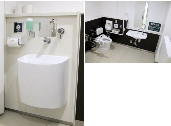
車いす使用者やお子様連れ、オストメイトなど、さまざまな使用者に配慮して、手すり、背もたれ、ベビーシート、汚物流しなどの設備を完備している。
