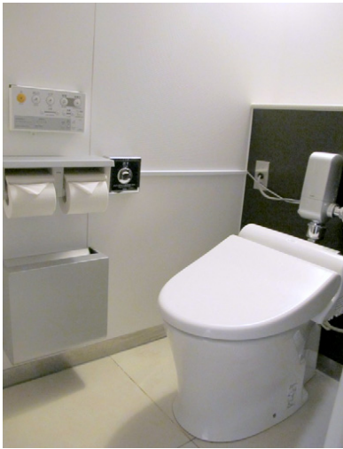
環境に配慮して節水型便器を採用し、音姫(擬音装置)機能を搭載したウォシュレットを設置している。
