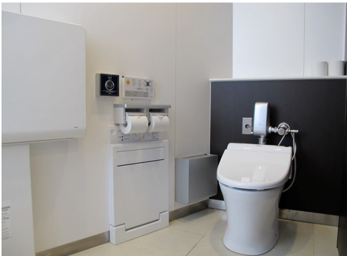
広めの大便器ブースには、お子様を寝かせておむつ替えができるベビーシートや、立ったままおむつ替えもできるフィッティングボードを備えている。
